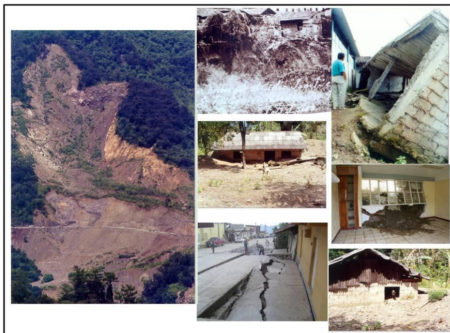
Figura V.31.- Mosaico de imágenes que muestran los impactos de las precipitaciones ocasionadas por las tormentas tropicales. Fuente: imágenes tomadas de Cupreder, 2005.
