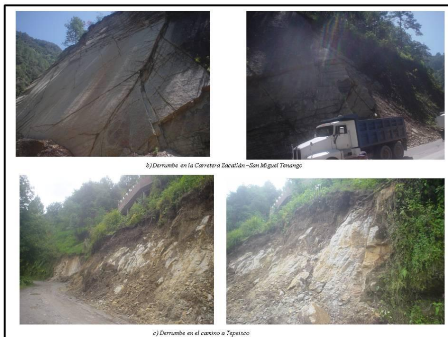
Figura V.20.- Imágenes de derrumbes los caminos del municipio de Zacatlán
